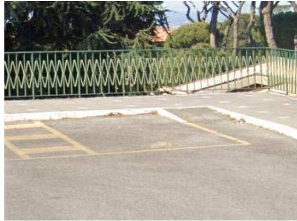
Rampe disabili in corrispondenza posto auto disabili, per aggiunta – Viale S. G. Battista de la Salle (Castel Gandolfo)
