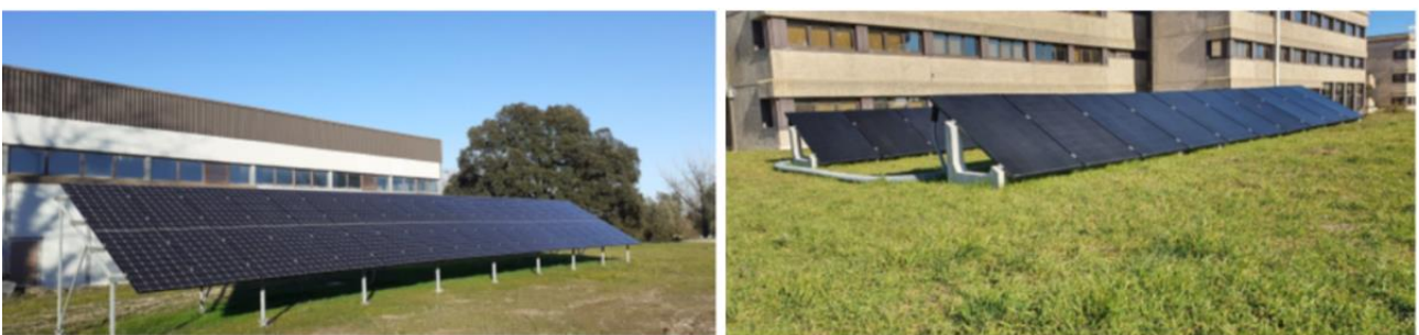
Figura 9-29. Componenti sistema S.A.P.I.EN.T.E.: a sinistra il campo fotovoltaico da 11,4 kW p ; a destra il campo termo-fotovoltaico (PVT)
