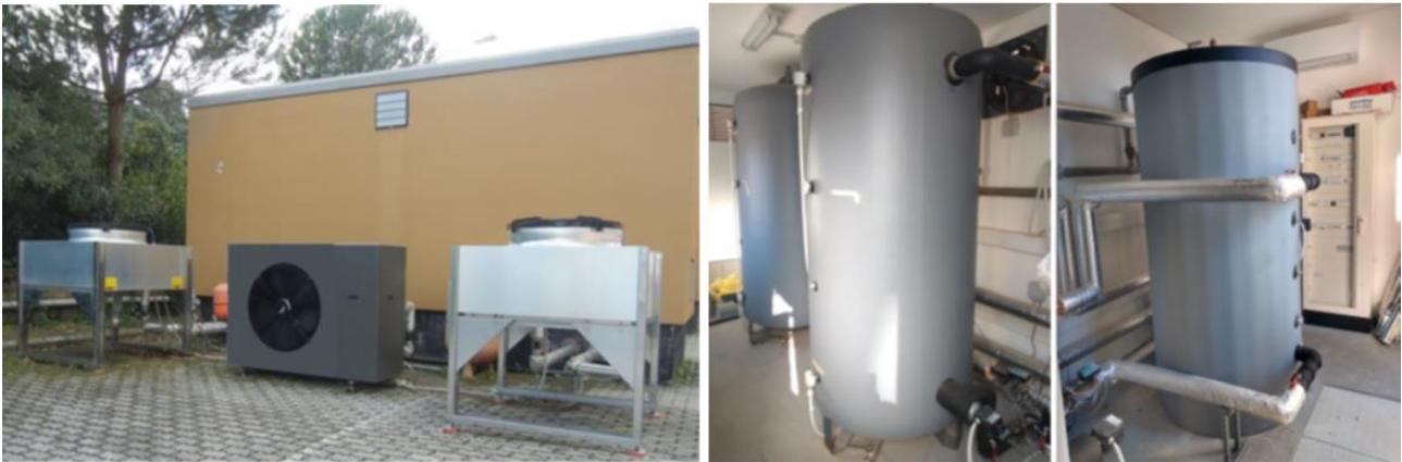
Figura 9-28. Componenti sistema S.A.P.I.EN.T.E.: a sinistra la pompa di calore e il dry cooler, a destra sistema di accumulo termico
